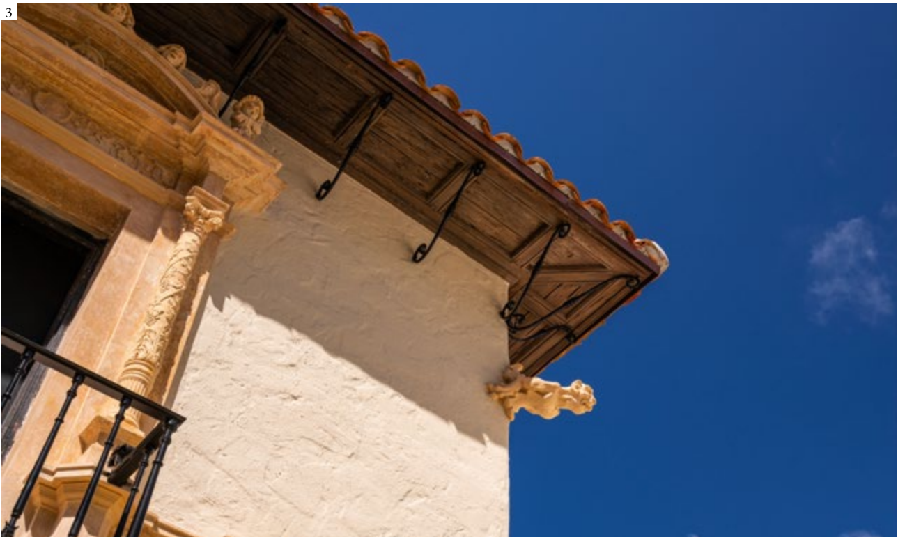
1, 2: Images of the gargoyle fragments. 3: Eave with a reconstructed gargoyle | 1, 2: Imágenes de los fragmentos de la gárgola. 3: Alero con una gárgola reconstruida | 1, 2: Imagens dos fragmentos da gárgula. 3: Beiral com uma gárgula reconstruída (3: Alex Tarajano)
