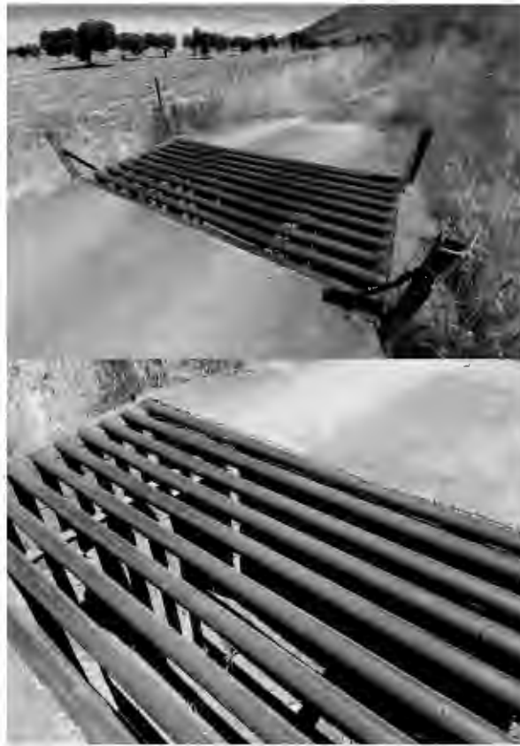
Figura 4: Ejemplo de paso canadiense anticuado y obsoleto, con foso profundo y sin aberturas laterales ni rampas de salida.
