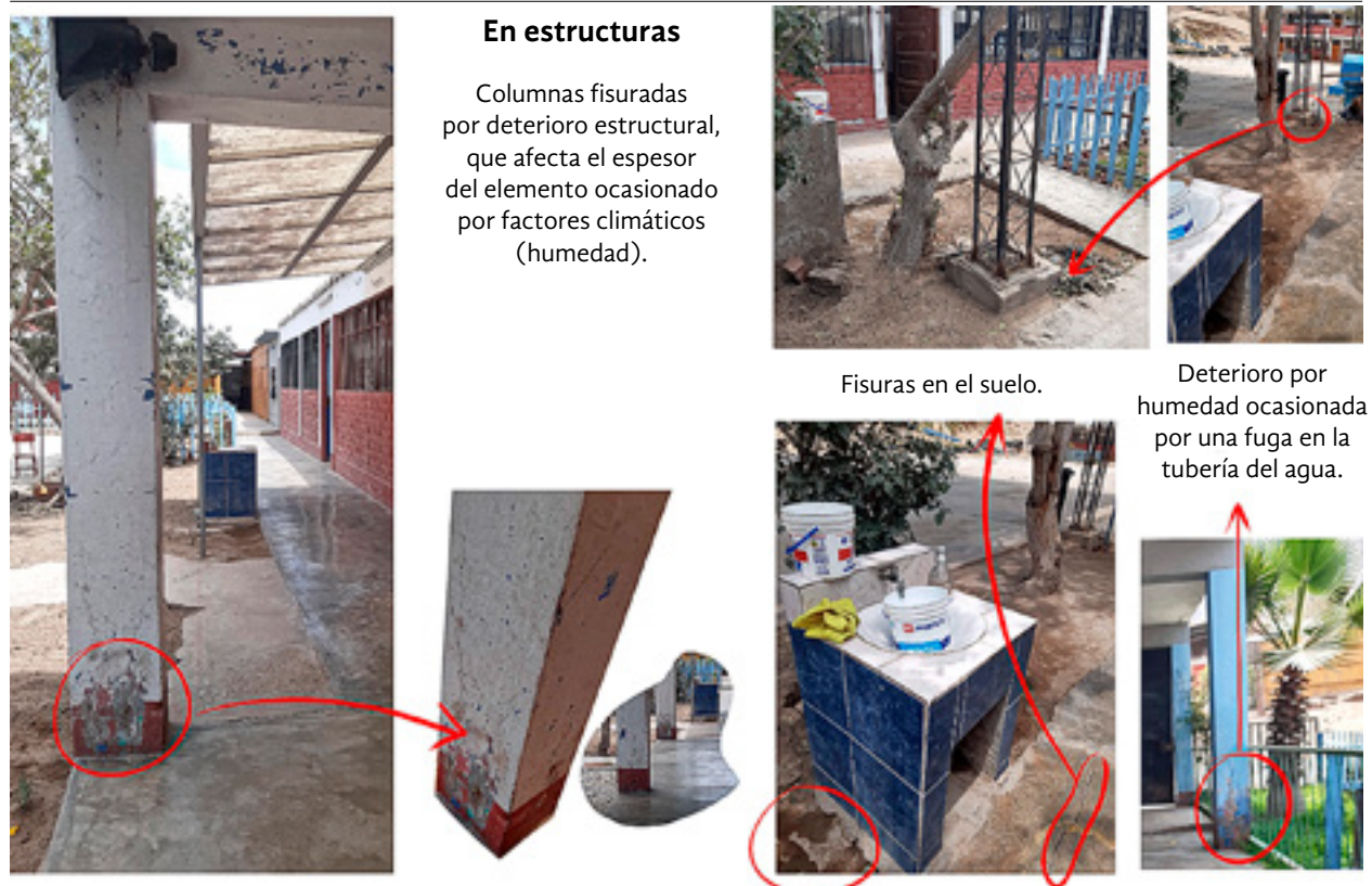
FIGURA 9 DETERIORO EN ESTRUCTURAS EXTERIORES (COLUMNAS Y SUELO)
