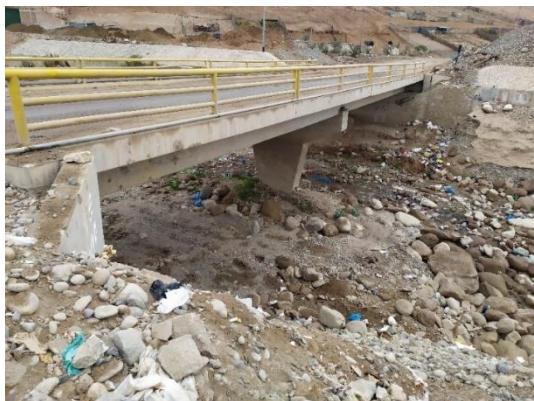
Figura 11. Puente sobre el río Seco, se observa acumulación de material.
