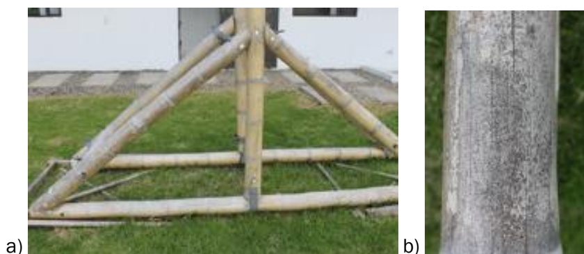
Figura 10. a) Deterioro en toda la estructura; b) mancha y deterioro causado por hongo.
