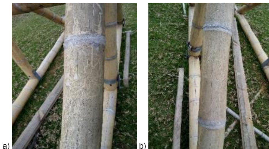
Figura 4. a) Afectación en elemento diagonal; b) lesión luego de exposición.
