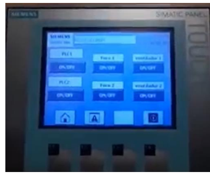
Fig. 3. HMI de control local.
