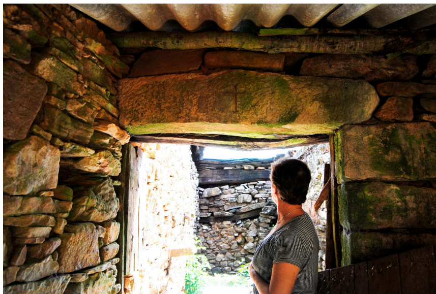
Una cruz labrada en el dintel de la puerta del establo protege al ganado frente al mal de ojo y la enfermedad. Fuente: elaboración propia
