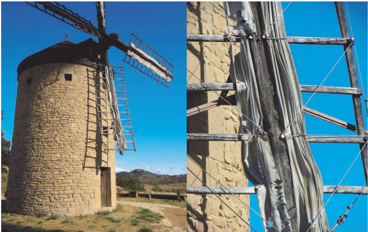
Estado actual de las velas, rotas, y la madera sin pintar.
