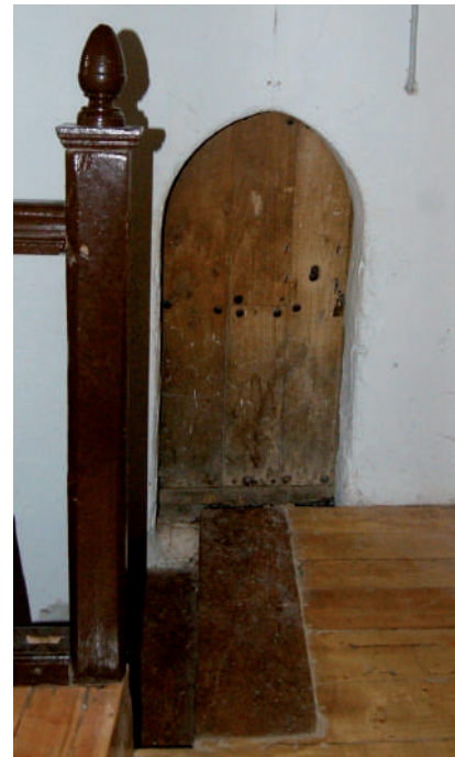
Fig. 19. Puerta de acceso con arco ojival, para entrar desde el coro a la escalera de caracol de la torre.
