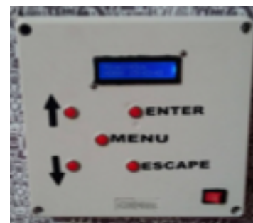
Ilustración 9.- Circuito de control en la caja de proyecto
