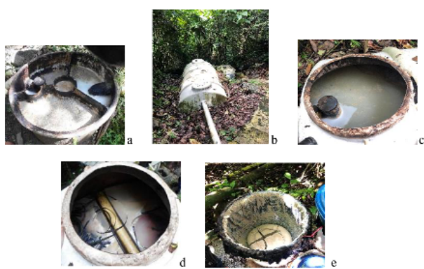
Figura 3. Sistema de tratamiento del restaurante. a) Trampa de grasas. b) Sistema anaerobio compacto (Tanque séptico + FAFA). c) Tanque séptico. d) Zunchos del FAFA. e) Lodos del proceso fisicoquímico
