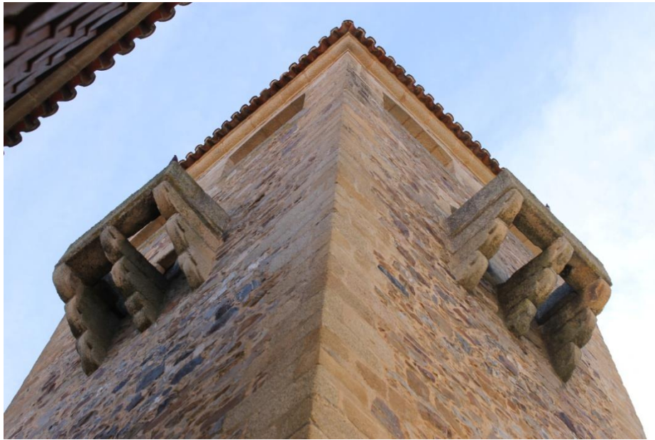
Fig. 15. Matacanes de la torre esquinera del Palacio de los Golfines de Abajo.
