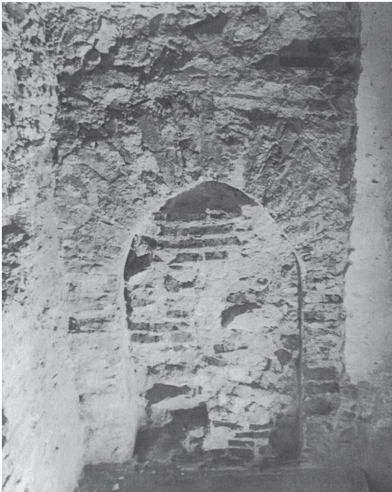
Fig. 28.- Huella, desde la escalera de subida al campanario, de la ventana o puerta, actualmente cegada, que se situaba en la pared norte de la capilla del Espíritu Santo.
