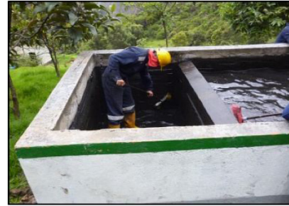
Figura 7. Mantenimiento y limpieza del sistema actual
