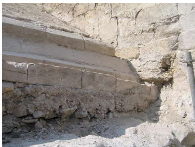
Restos encontrados de la primitiva cubierta de sillar de piedra del ábside central.
