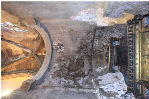
Salas y humedades en las bóvedas.
