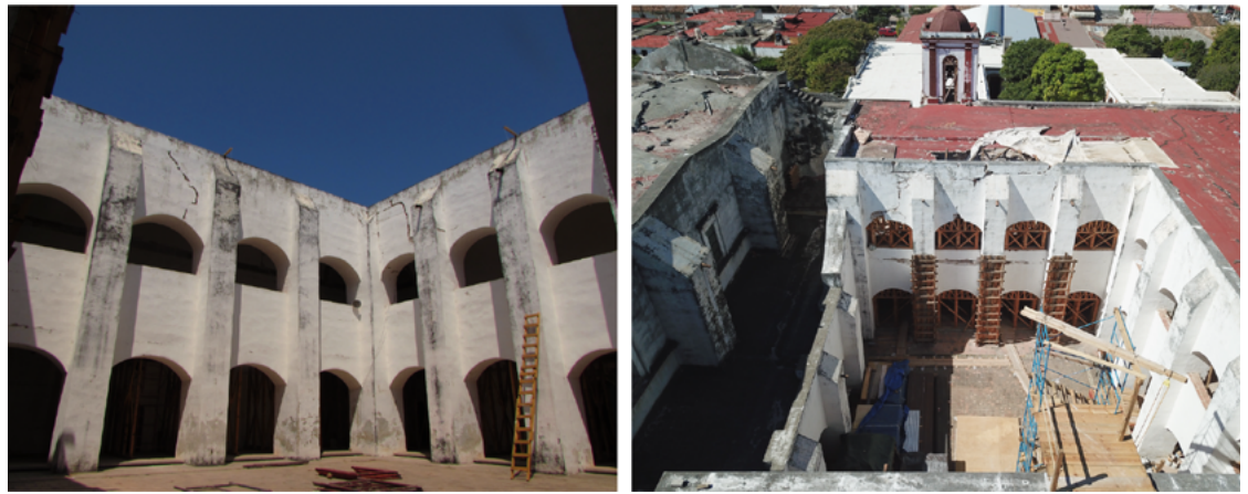
FIGURA 1. Imagen del claustro del exconvento y vista aérea (Fotografía: Fernanda Martínez y Fidel Ugarte, 2019; cortesía: Centro INAH Oaxaca, México).
