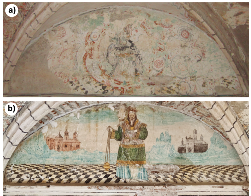
FIGURA 2. Pintura mural del luneto del deambulatorio poniente, planta baja. a) Capa superpuesta antes de su liberación. b) Capa pictórica después del proceso de liberación (Fotografía: Roxana Flores y Carlos Vichido, 2019; cortesía: Grupo Tares/Fundación Alfredo Harp Helú Oaxaca, México).
