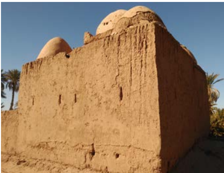
Northeast corner of the Marabout. Condition of the exterior finishings prior to the restoration | Esquina noreste del Morabito. Daños en acabados exteriores previos a la intervención | Esquina noroeste do marabu. Danos nas fachadas exteriores antes da intervenção
