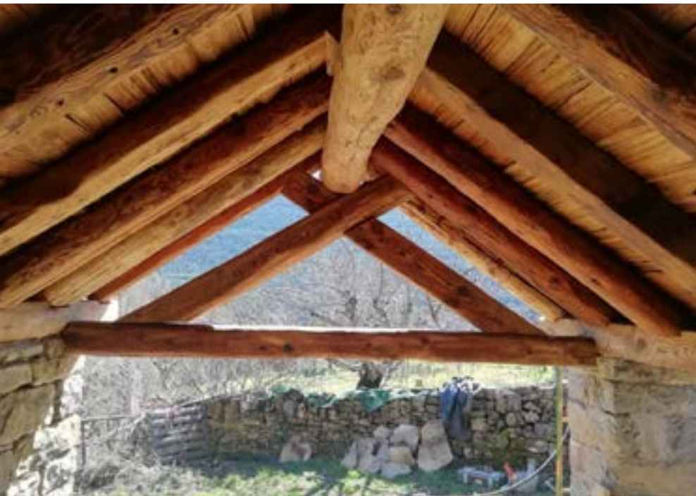
Roof structure from inside | Detalle interior de la estructura de la cubierta | Pormenor interior da estrutura da cobertura
