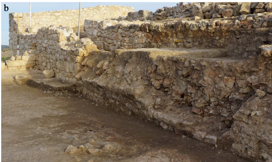
Figura 6. a. caída del paramento norte del muro UE 260, tras las fuertes lluvias; b. estado de deterioro del interior del muro, fracturado por su inclinación
