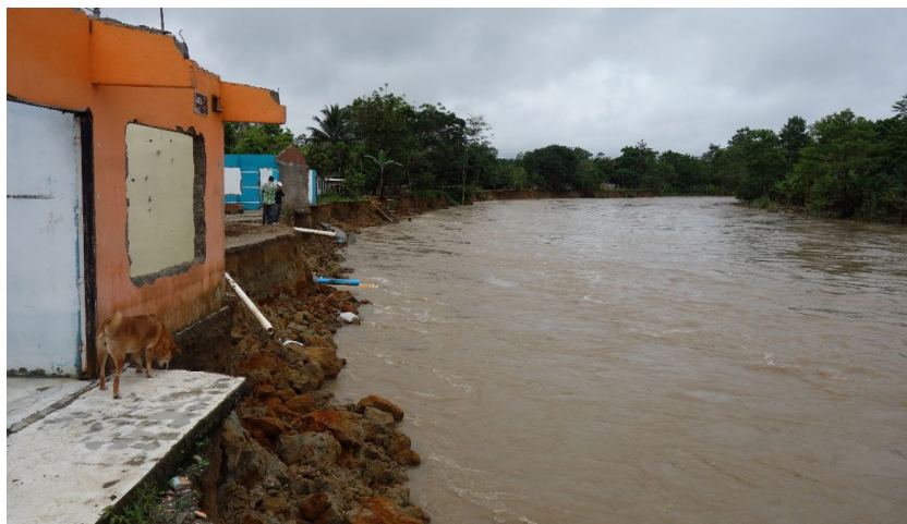
Figura 6. Socavación de las orillas del río Caquetá en el barrio Simón Bolívar
