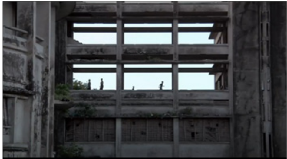
Abb. 1: Fehlende Fenster I.
