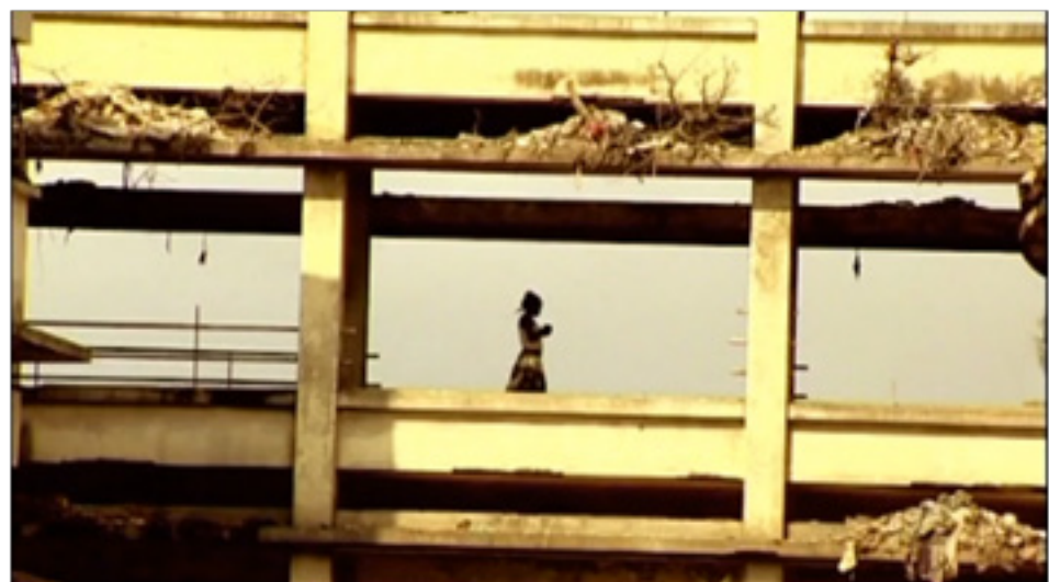
Abb. 2: Fehlende Fenster II.
