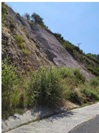
Fig. Talud inestable del P.K. 10+580, previamente gunitado por la presencia de cuñas de deslizamiento activas: vista general del frente.
