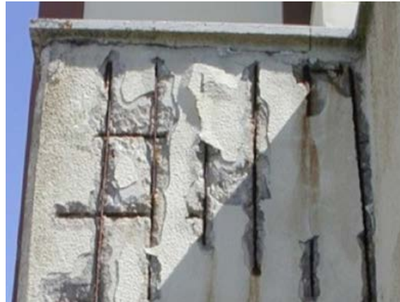
Fig. Ejemplo de ataque por cloruros en una estructura de hormigón armado (Fuente: CETIM)
