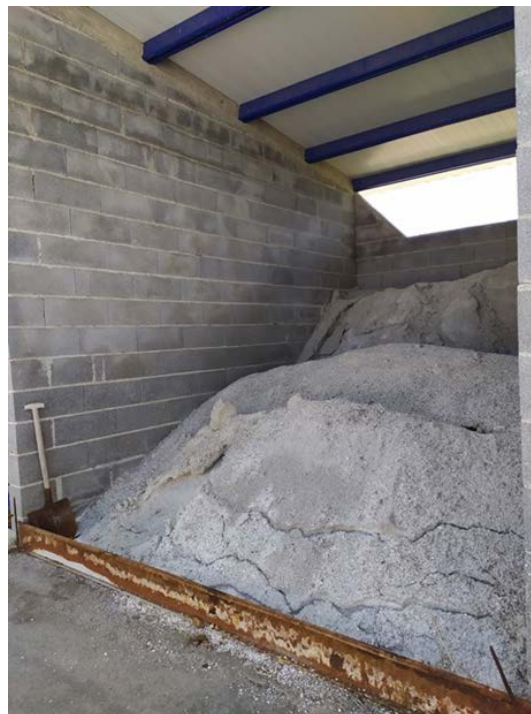
Fig. Depósito de sal del Centro COEX , donde se aprecia el ataque salino en el elemento metálico de contención del acopio. Fotografía de los autores.
