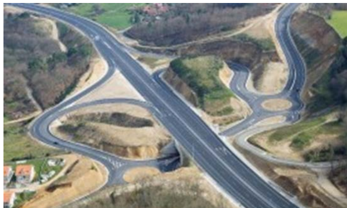
Fig. Vista aérea del Enlace Centro-Celanova de la Autovía, durante el proceso de construcción de la infraestructura (Fuente: AUCEL)
