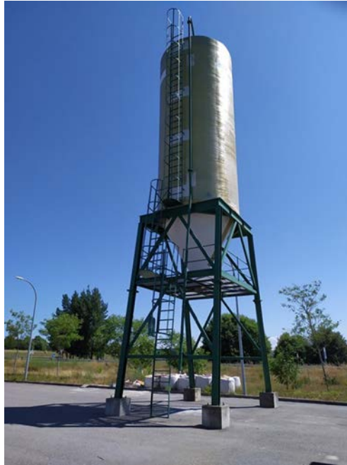
Fig. Silo de fundentes ubicado en el Centro COEX de la Autovía Ourense-Celanova. Vista general. (Fuente: los autores).
