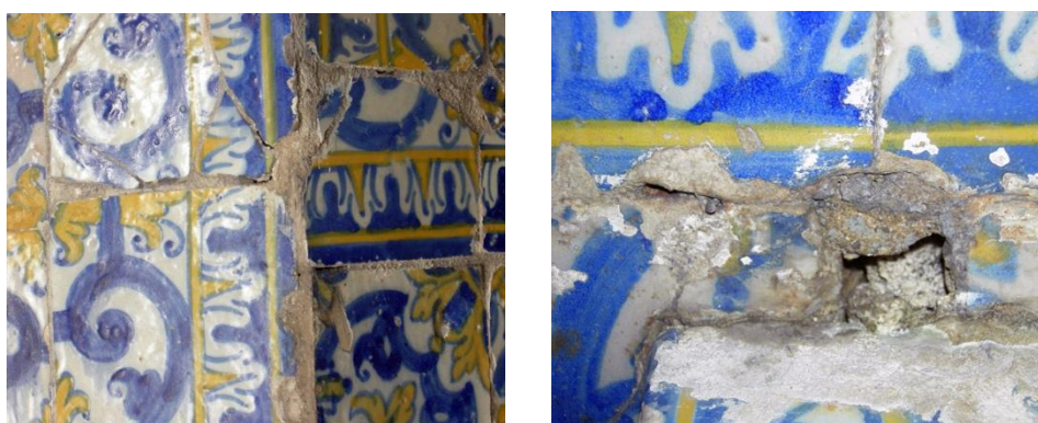
Fig. 18 e 19: Fissuras existentes em um painel de azulejos e lacunas existentes em um painel de azulejos. Capela de São Bartolomeu, Aveiro. Fotos: NR.
