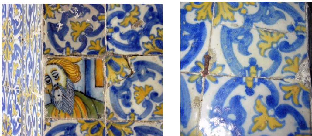
Figs. 20 e 21: O azulejo figurativo foi utilizado para preencher o espaço vazio criado pela perda de um outro azulejo aí aplicado originalmente e Manchas de oxidação provocadas pela inserção de um elemento metálico no painel de azulejos. Capela de São Bartolomeu, Aveiro. Fotos: NR.
