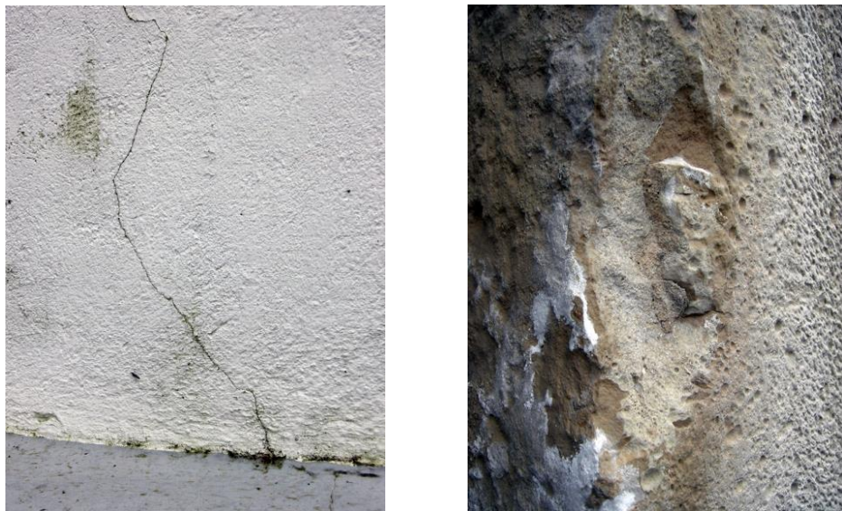
Figs. 11 e 12: Fissura existente no exterior da capela y pormenor da erosão existente no pórtico da capela. Capela de São Bartolomeu, Aveiro. Fotos: NR.
