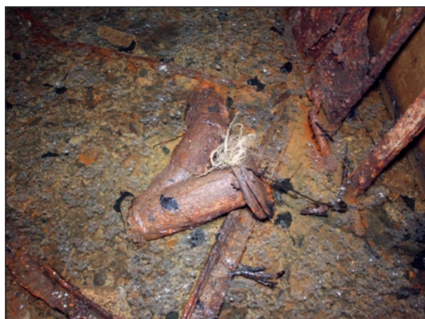
Figura 34a: Restos de tuberías en el interior uno de los abrigos de los sirvientes artilleros, debido a su estado de corrosión es difícil determinar su función principal, ventilación o calefacción.
