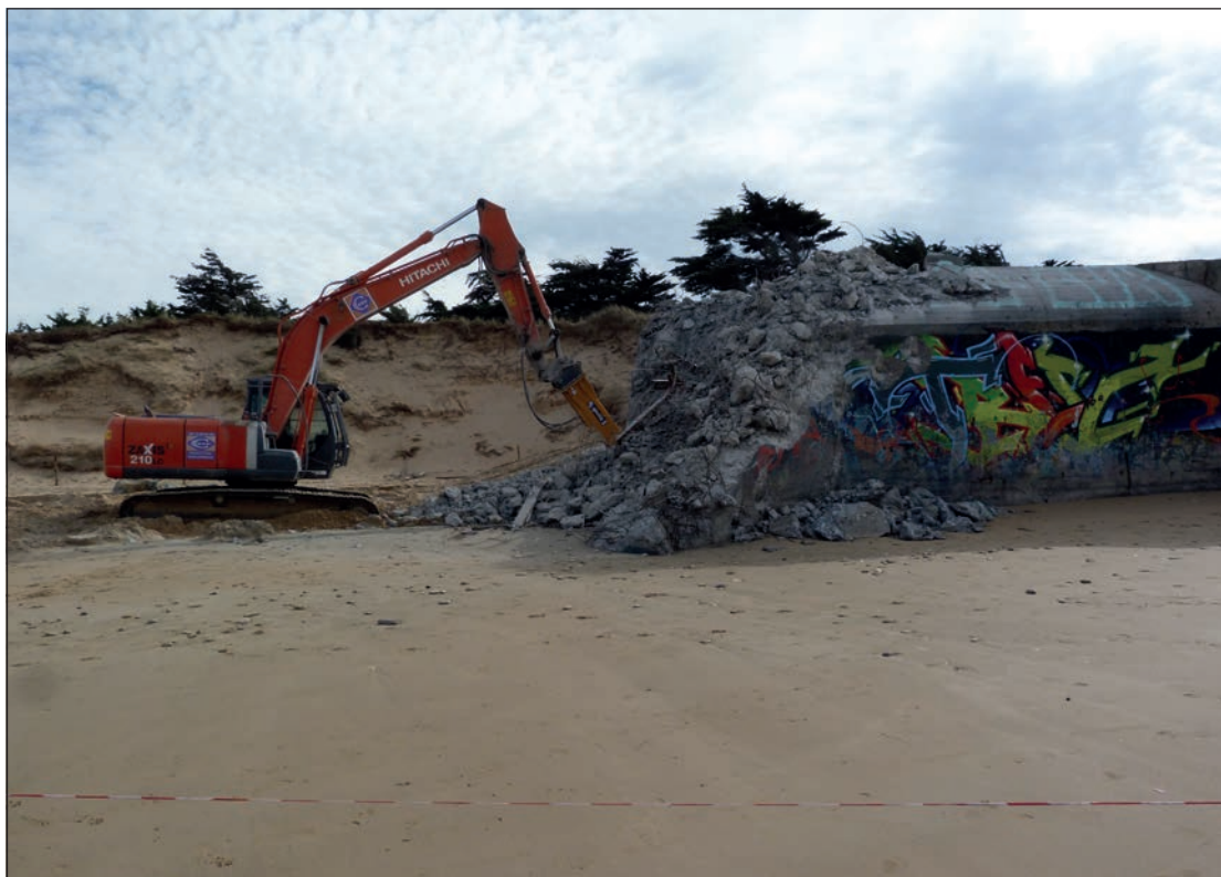
Figura 16. Maquinaria pesada realizando los trabajos de demolición de una de las casamatas artilleras dobles de la batería Klara en septiembre de 2016. El hormigón de los escombros se reutilizará como material de relleno en el dique de Doreaux en la población de Saint-Clement-des-Baleines, dentro del programa de prevención de inundaciones (fotografía de Jean-Luc Moser).
