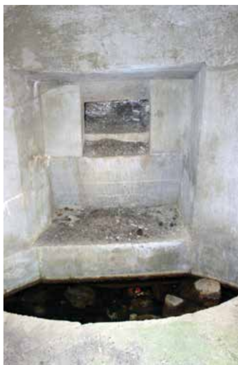
Figura 18. Interior del nido de ametralladora con aspillera obstruida (subelemento 2 de Belagöasoröa). Fuente: Pablo Orduna Portús.
