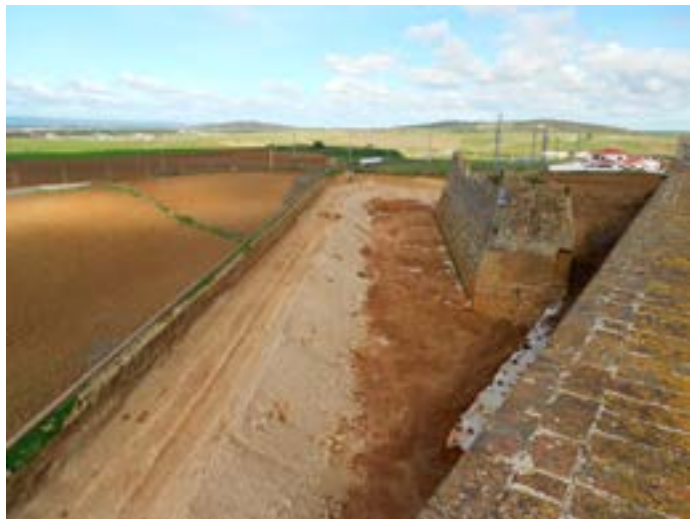
Nº 22.- Reposición del terraplén (2013), cubriendo las galerías de contraminas adosadas al caballero. La coronación de la cara oeste se desplomó hacia el interior. (J.M. Vázquez).
