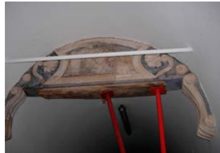
Nº 32.- Grieta en el arco de una de las capillas laterales tras la operación de vaciado. Atirantado de la bóveda. (J.M. Vázquez).
