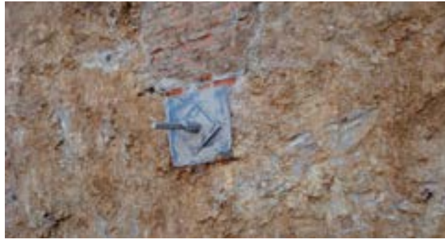
Nº 33.- Anclaje exterior de uno de los tirantes de acero. (I. Puras).
