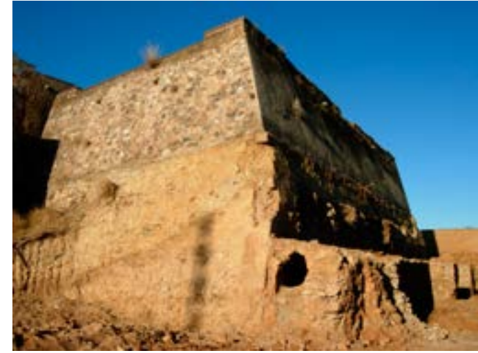
Nº 24.- Galería de contramina adosada a la cara norte del caballero, antes de su desplome. (J.M. Vázquez).
