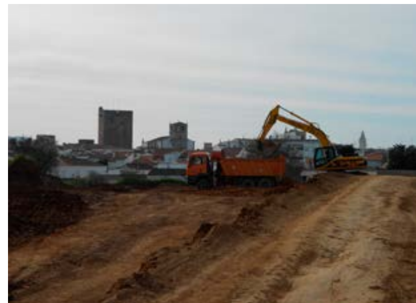
Nº 41.- Extracción de tierras en el revellín de Santa Ana. (J.M. Vázquez).
