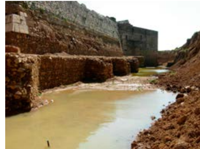
Nº 25.- Galería de contramina con sus ramales de salida en la cara oeste del caballero, desplomada en su coronación hacia el interior (2010). (J.M. Vázquez).
