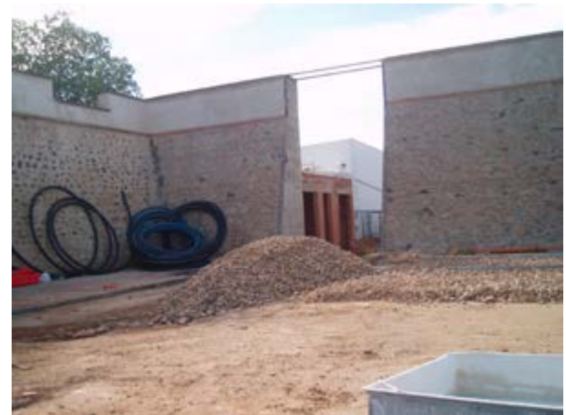
Nº 45.- Brecha en la cortina del baluarte de San Blas (2009). (E. Vidigal).
