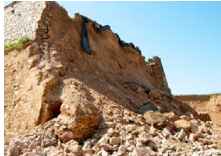
Nº 28-29.- Desplome de la cara norte del caballero sobre las galerías de contraminas. (J.M. Vázquez).
