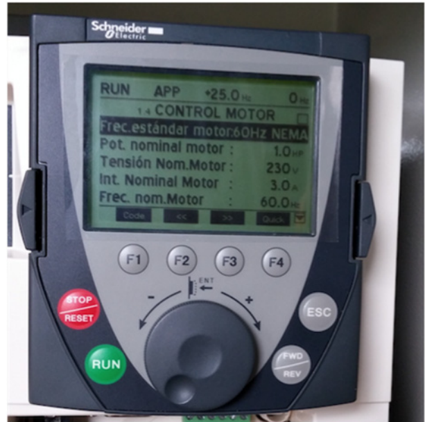
Figura 4. Configuración de parámetros del motor a controlar [Potencia, voltaje, corriente y frecuencia].
