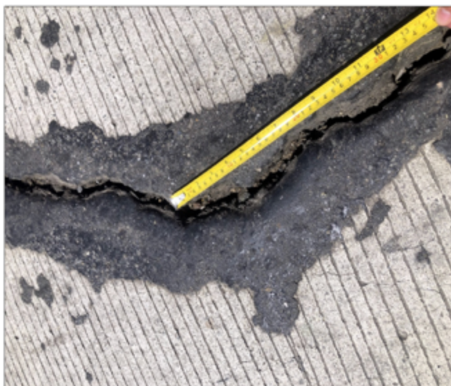
Figura 6. Grieta lineal identificada y medida en campo
