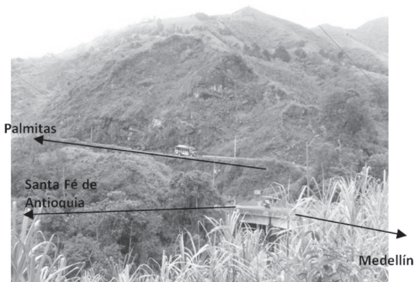
Figura 1. Talud sobre la margen derecha de la carretera en dirección Medellín – Santa Fe de Antioquia.
