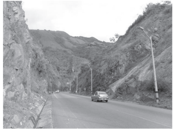
Figura 2. Talud sobre la margen izquierda de la carretera en dirección Medellín – Santa Fe de Antioquia.
