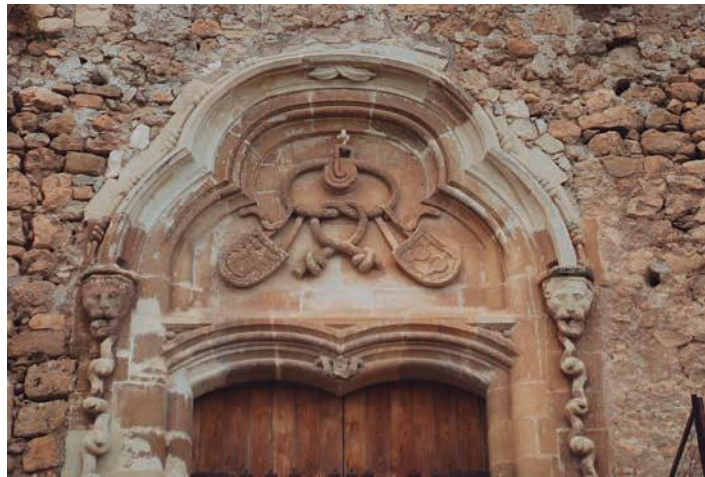
Fig. 5. Fachada de la fortaleza de La Guardia, realizada en tiempos de D. Gonzalo y su esposa Inés. Simbolizando la unión de La Guardia y Santofimia (Fotos del autor)
