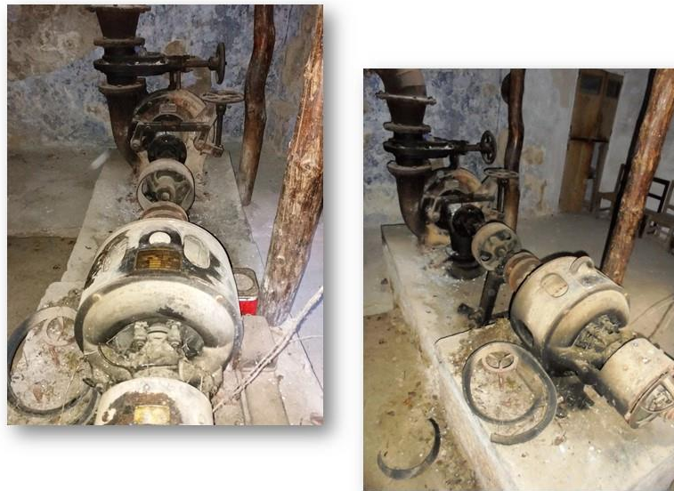
fg.20) Vista del conjunto monobloc: Generador – Turbina montado sobre una bancada de hormigón.
