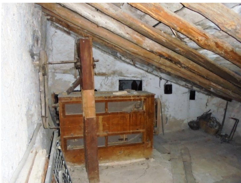
fg.15) Detalle de las vigas y faldón de madera de la cubierta.
