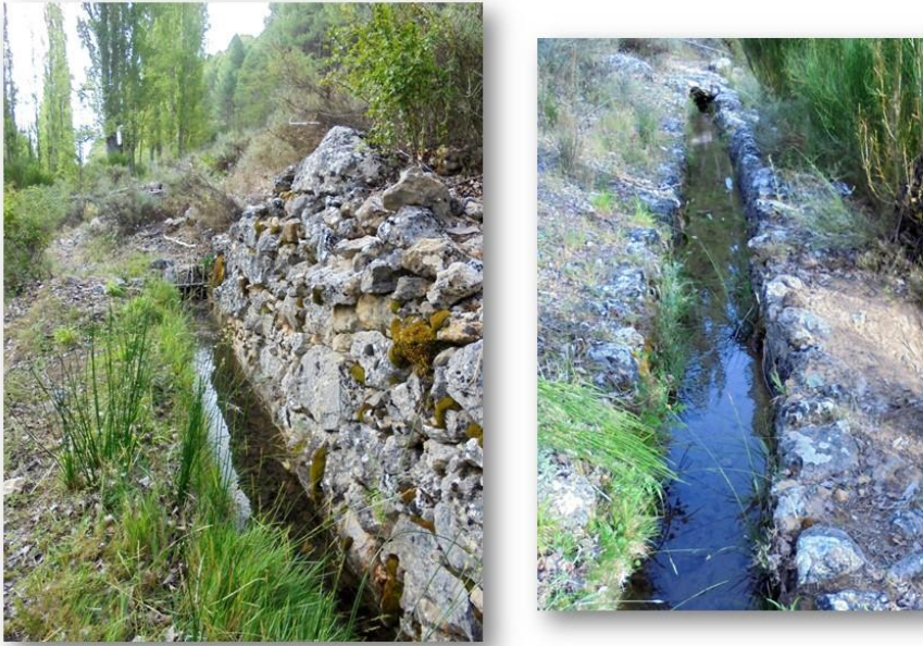
Fg.46) Detalle de las escolleras y de la canalización de algunos tramos del caz
