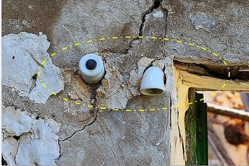
Detalle del aislamiento, aislador y pasamuros en porcelana blanca, para la entrada de la línea eléctrica de 220 V a una vivienda.
