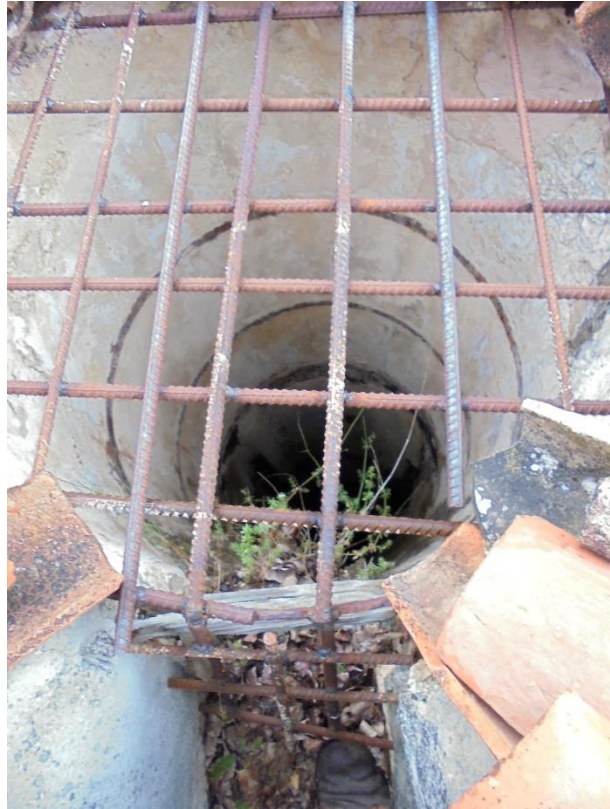
Fg.61) Vista de la parte superior del cubo (La reja metálica que se observa, está colocada para evitar accidentes a personas. En su origen esta protección no existía, pues el cubo tenía su mantenimiento y era necesario que estuviera abierta).
