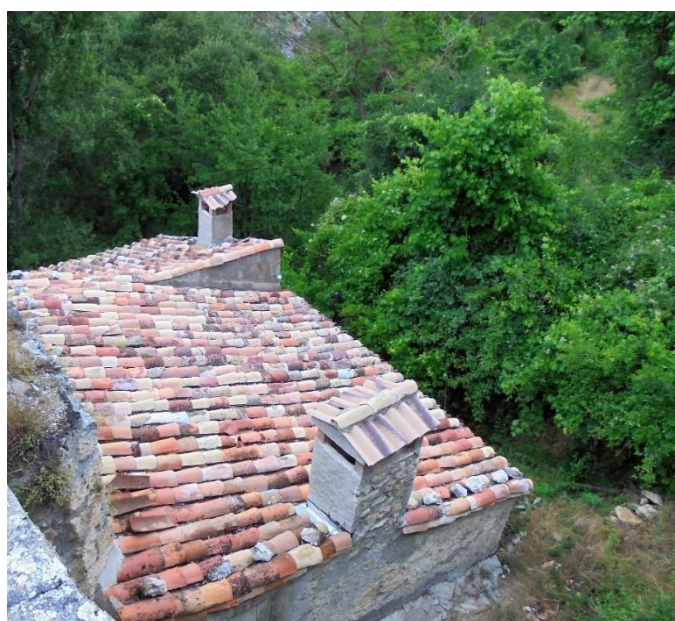
fg.13) Cubierta con teja árabe a un agua en edificio anexo (Máquina de borra y turbina-generator).
