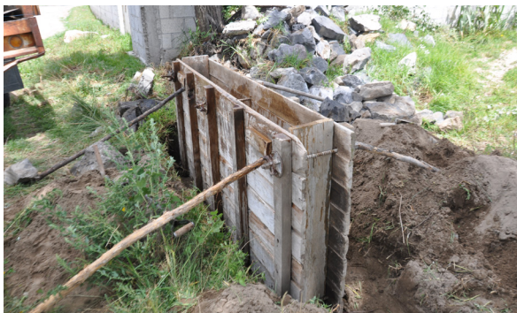
Figura 15. Encofrado de madera utilizado en la actualidad, Tepeyahualco, Puebla (Acervo del LABPySCT, María de los Ángeles Vizcarra)
