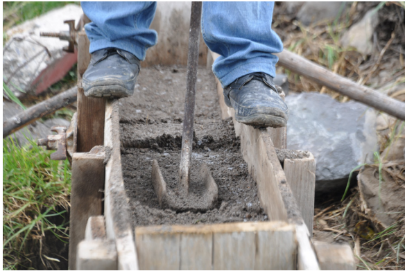
Figura 17. Proceso constructivo: apisonado, Tepeyahualco, Puebla (Acervo del LABPySCT, María de los Ángeles Vizcarra)
