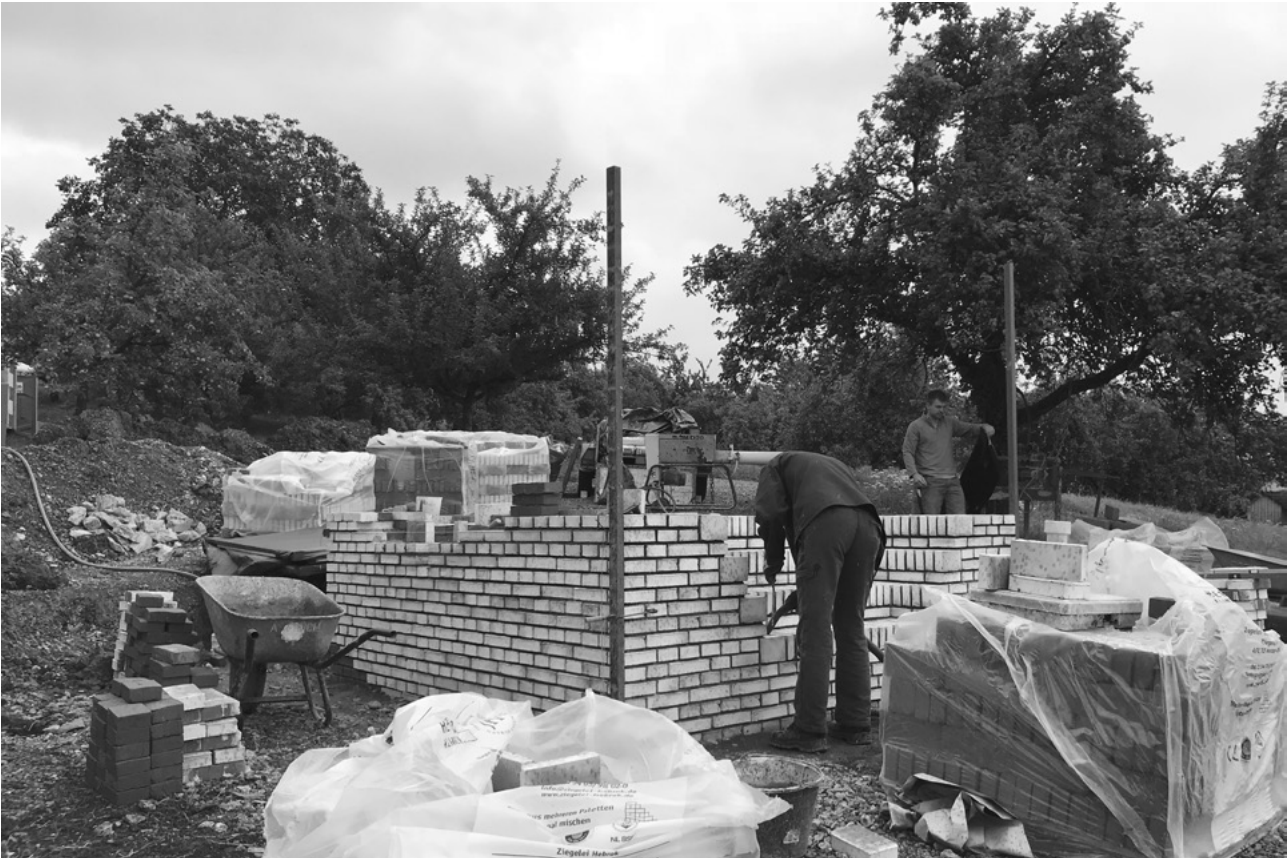
Building process. Laying the bricks | Proceso de construcción. Colocación de los ladrillos | Processo construtivo. Assentamento dos tijolos
