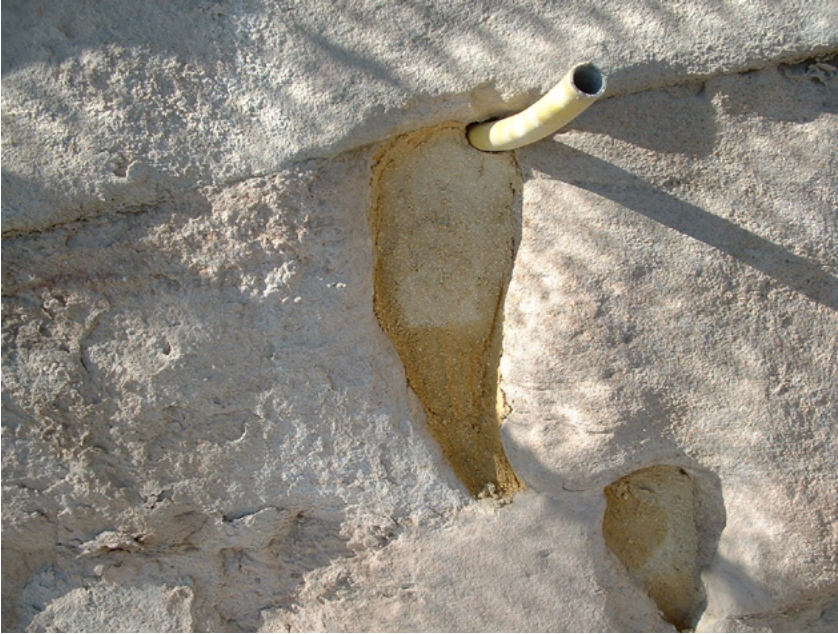
Detail of the air vent installed in a joint, prior to the filling injection to the interior | Detalle del respiradero instalado en una junta, previo a la inyección del interior | Pormenor da ventilação instalada numa das juntas, antes da injeção do interior (Rodrigo de la Torre)
