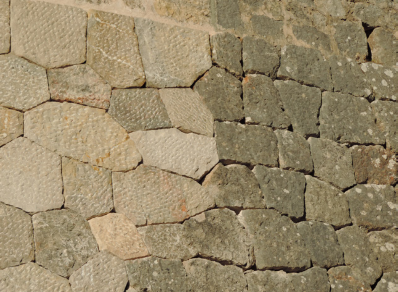
Meeting point of the old wall with the new addition | Encuentro del antiguo muro con la parte reconstruida | Encontro do antigo muro com a parte reconstruida
