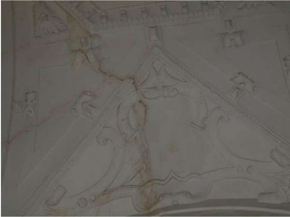
Fig. 7: Grieta en la capilla del Pilar. Fuente: Madrid Pinilla (2016a: 22).
