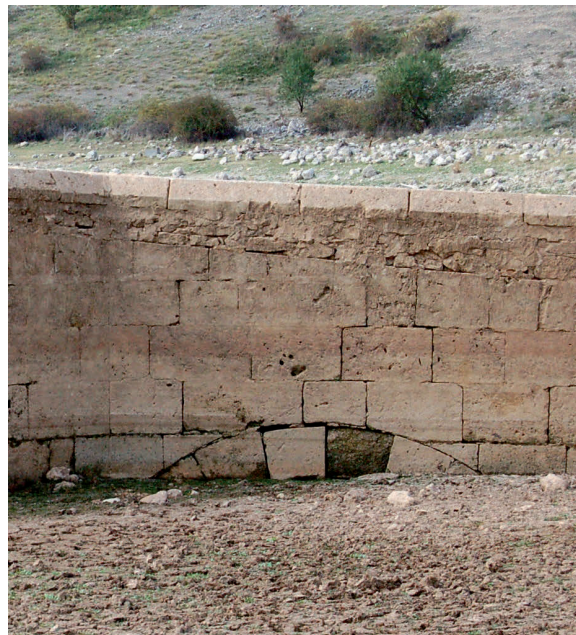
Fig. 4. Primer arco del puente de Maderuelo, semienterrado en los sedimentos de la presa. La cantería tiene las características de una fábrica del siglo XVIII. La albardilla no es paralela a la pendiente del muro por haberse rectificado la pendiente para disminuir su porcentaje.
