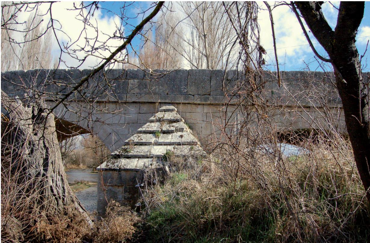
Fig. 12. Espolón del puente de Montejo cubierto parcialmente por los sedimentos del río y la vegetación espontánea que lo ahoga.
