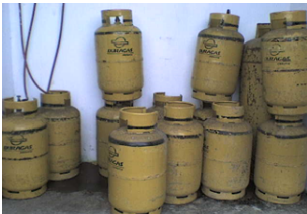
Figura 1. Almacenamiento de GLP en cilindros.
