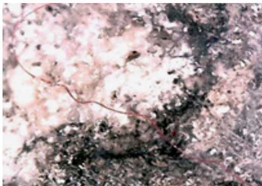
Figura 9: Sales y microrraíces observadas mediante microscopía USB Digital en fachada recién restaurada Fuente: S. Arencibia (2018)
