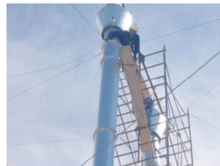
Figura 5. Amarre de las chimeneas, salida de gases de combustión. Fuente: Autores.
