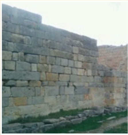
Fig. 54. Ksar Lemsá. Detalle de la obra a la izquierda de la puerta. Hiladas inferiores con sogas y tizones de distinto tamaño, donde a veces repiten el tizón o la soga. Sobre ellas, la hilada de menor altura e hiladas más desordenadas.
