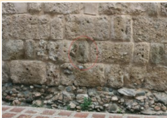
Fig. 98. Sillares a soga y tizón en calle Trinidad. Marcado en rojo el tizón con forma de clave de un arco
