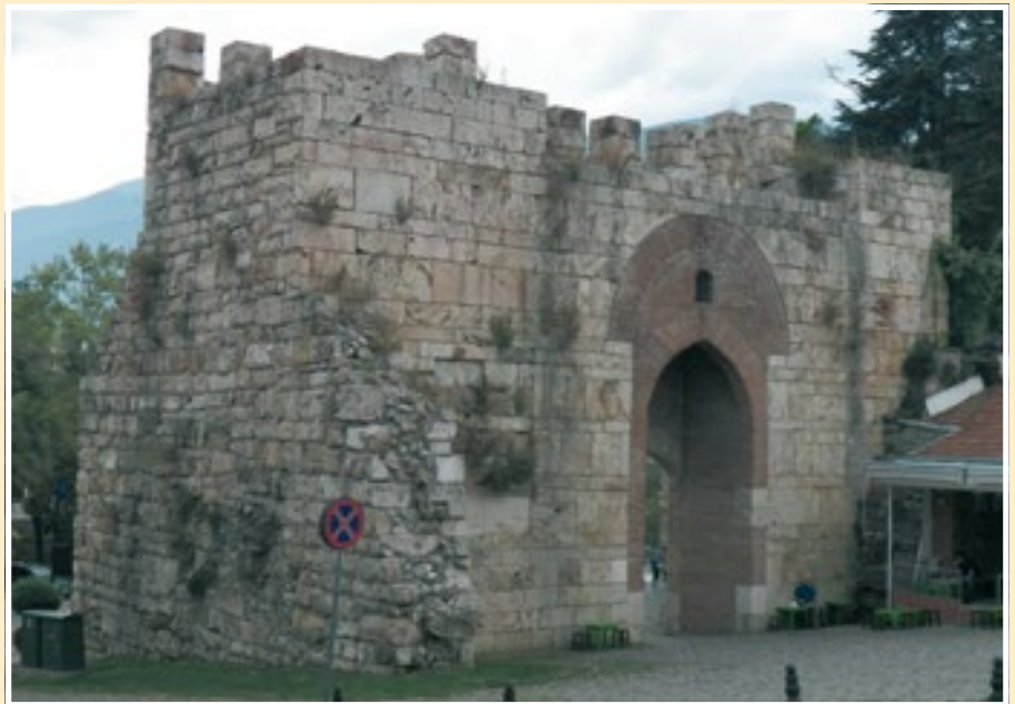
Fig. 21. La misma puerta desde atrás. A la izquierda restos de la muralla bizantina, muy irregular, más parecida a la que existe sobre el zócalo del lienzo 1 en la plaza de la Iglesia, aunque esta contiene algunas hiladas discontinuas de sillares de menor altura. Y sobre este muro, y el resto de la puerta, la obra otomana, mucho más regular.
