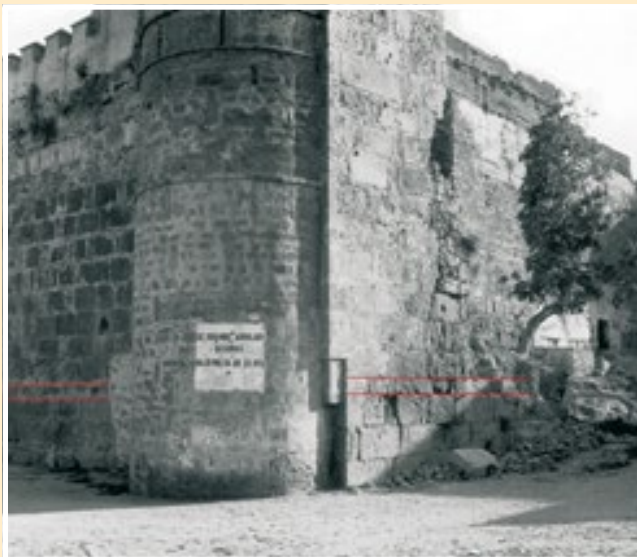
Fig. 4. Imagen del archivo Temboursy de la esquina noreste de la Torre del Cubo, con las hiladas de sillares acostados sobre hiladas a soga y tizón. De hecho, toda esa cara norte de la torre, incluidas las partes altas, pudo pertenecer a la misma época. La hilada de menor altura correspondiente a la cara norte de la torre fue descubierta por Alejandro Pérez Malumbres, gran conocedor del castillo, al que ha dedicado muchos años de estudio.
