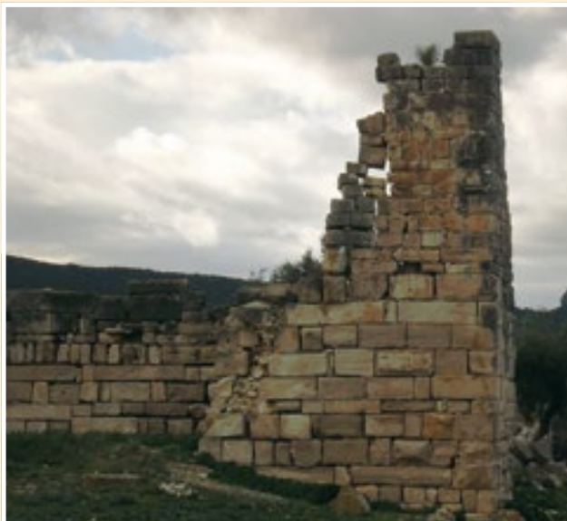
Fig. 58. Ain Tounga. A la derecha los restos de una torre con aparejo desordenado, visibles algunas hiladas de menor altura en su base y sillares almohadillados de acarreo. A la izquierda, un par de hiladas de acostados entre otras, con un cierto orden a soga y tizón, y una con numerosa repetición de tizones. Es un claro ejemplo de la dificultad de establecer una regla en el aparejo bizantino, ya que depende absolutamente del material de expolio que poseen en el momento de la construcción.
