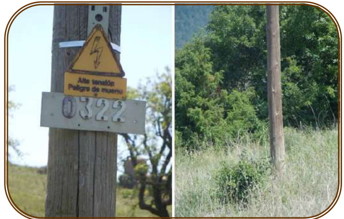
Línea eléctrica de Eguillor. Aviso peligro y poste anclado en el suelo.
