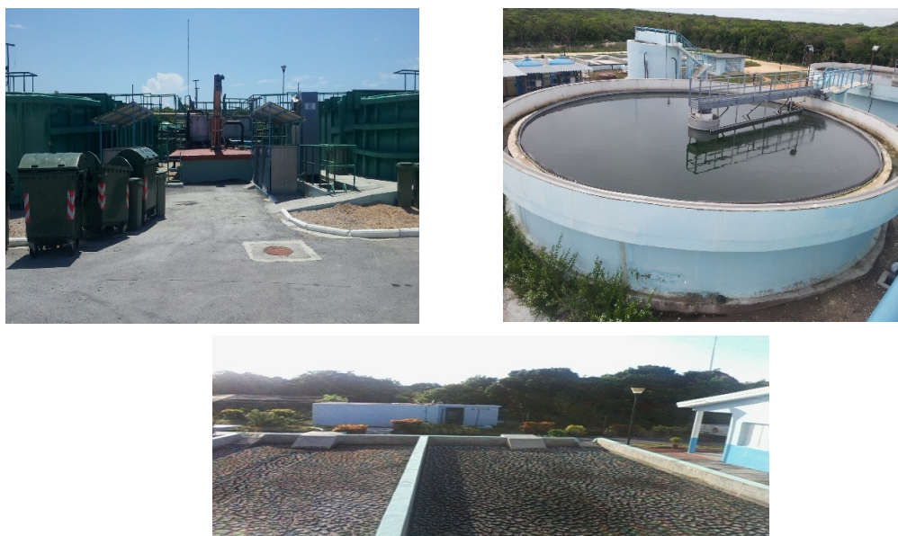
Figura 4: Planta de tratamiento de residuales
