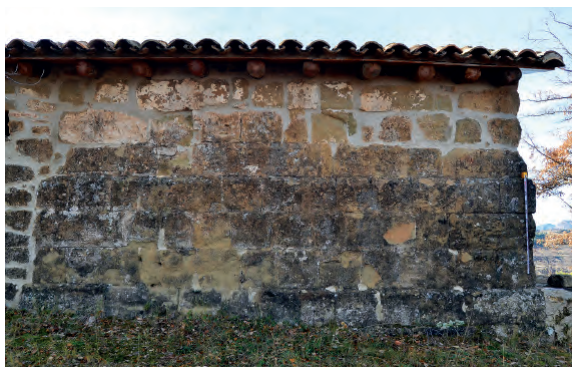
Fig. 9. Ermita de La Magdalena de Panzano. Muro oriental de la nave, en el que se aprecia la parte inferior del muro original de sillares.
