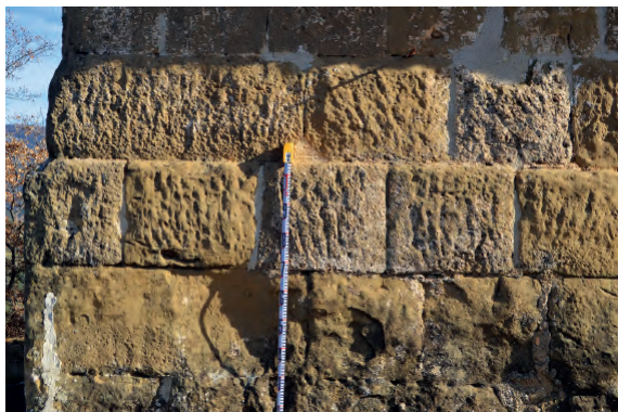
Fig. 13. Ermita de La Magdalena de Panzano. Muro oeste de la nave y esquina noroeste: detalle del aparejo original andalusí de opus quadratum , con sillares a tizón, sogas de esquina y terminaciones con almohadillado muy poco prominente alisado por medio de surcos de cincel y listel perimetral.
