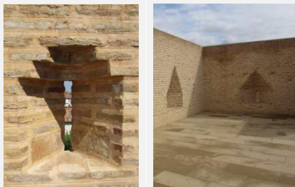
Distintos tipos de saeteras como defensas en la ronda o adarve del castillo de Marcilla.
