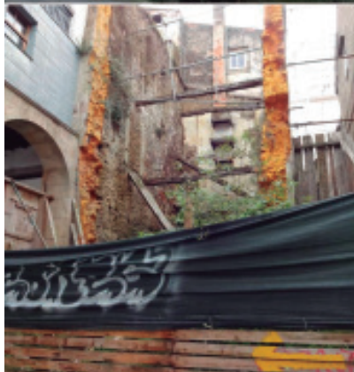
Fig.18. "Casa gótica" antes e despois do derrubo. La voz de Galicia e Catastro.
