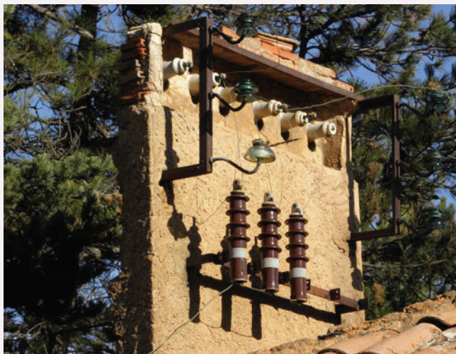
Salida en alta tensión hacia Ágreda y Ólvega.
