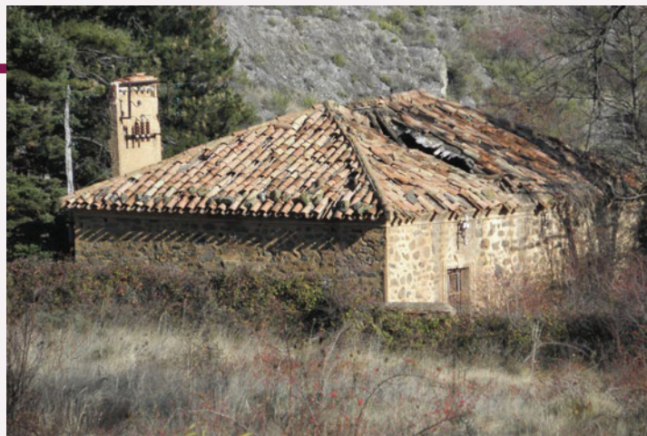
Central eléctrica de Aldehuela de Ágreda, inaugurada en 1940.
