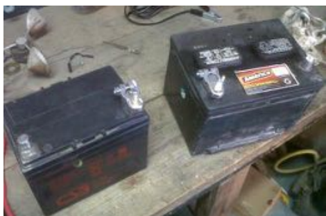
Figura 7a Baterías plomo-ácido, utilizadas en el sistema.
