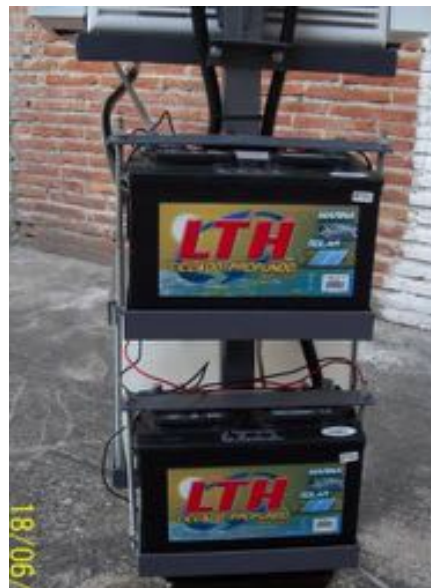
Figura 8 Baterías conectadas en paralelo.
