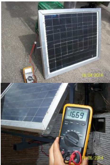
Figura 5 Panel solar o fotovoltaico.
