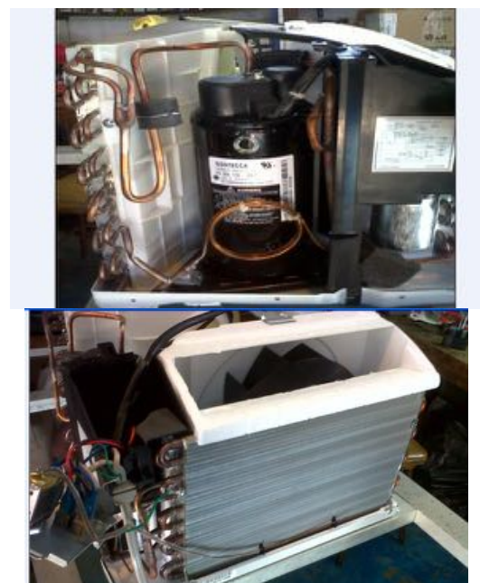
Figura 3 Unidad de enfriamiento.
