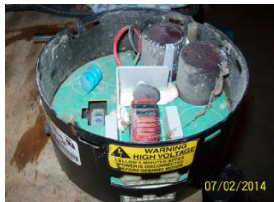
Figura 18 Tarjeta electrónica dañada.
