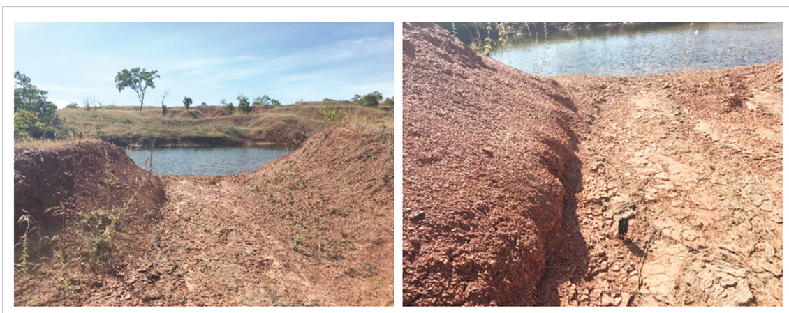
Figura 5. Vertedero con erosión en la cresta.
