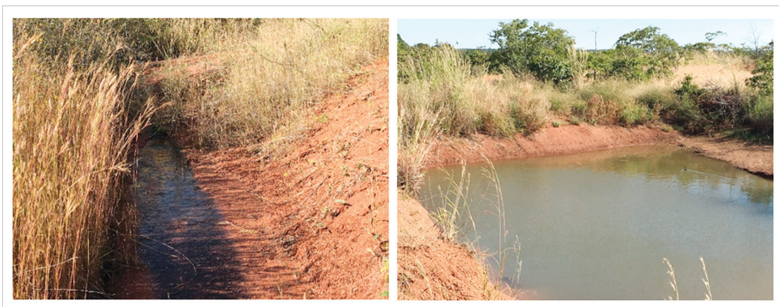
Figura 4. Presa con problemas de infiltración por la base. (Foto izquierda: vista de la parte inferior de la presa, el flujo de agua por la base se muestra. Foto derecha: vista de la cota superior de la represa).
